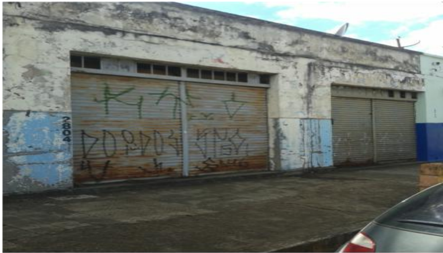
Foto 16 - Edifício em estado de abandono Fonte: Autor, 2016.
