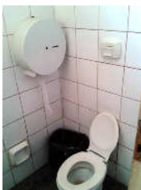
Figura 34 - Vaso sanitário na Turma B
