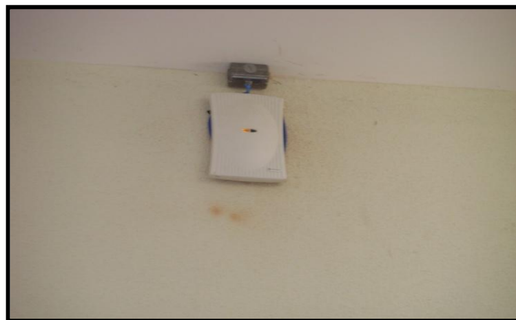
Figura 16 – Equipamento para conexão à rede sem fio (Wireless) Fonte: Autora
